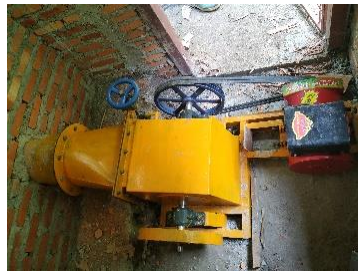
Gambar 9. Sistem turbin PLTMH diletakkan di dalam rumah turbin
