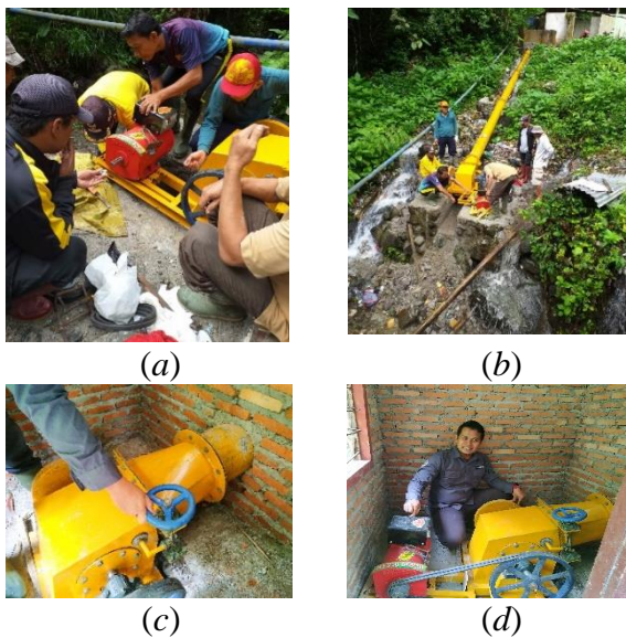
Gambar 6. (a) Pembersihan lokasi pembangunan PLTMH (b) pengukuran kemiringan pipa sebagai penghubung antara bak penampung dengan rumah turbin (c) pemasangan pipa, dan (d) pembangunan rumah turbin
